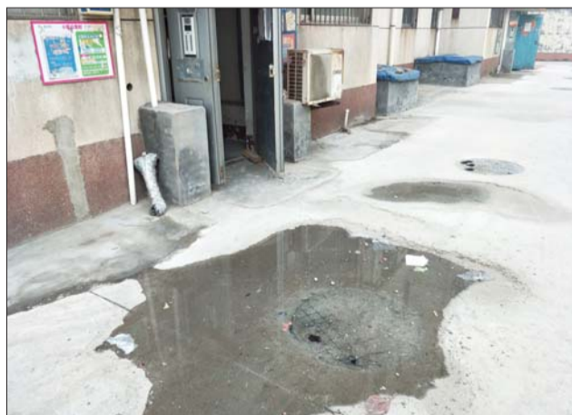
下水道井盖周围的一滩积水。 本报见习记者 杨文清 摄
