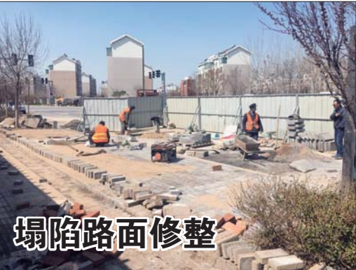
3月27日,记者注意到位于锦苑一区南门南侧的公交站塌陷的路面现已开始修整。现场一位工作人员表示,修整工作已进行了约一个星期,具体完工时间目前还不能确定。
