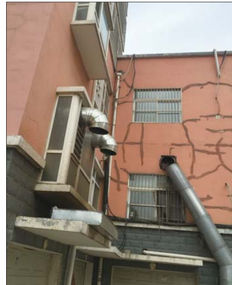
饭店排油烟管道直接伸出窗外。 本报记者 赵环宇 摄
