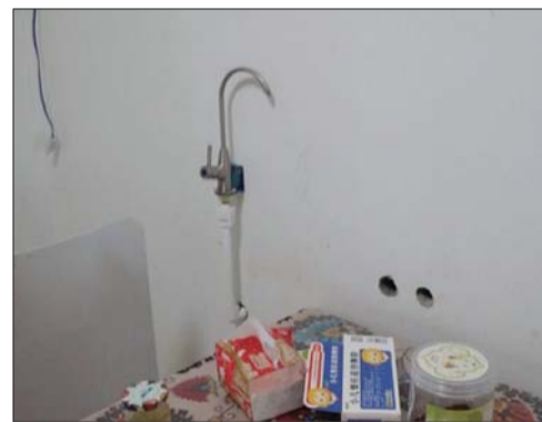
居民家中的直饮水水龙头安装在餐厅里。受访者提供
