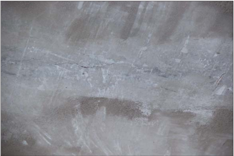
5号楼2单元801室张先生的裂缝正在维修，房顶水泥墙上的裂缝清晰可见。
