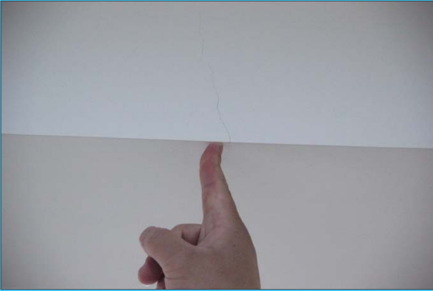
18号楼1单元702室的韩先生家去年修过一次，现在客厅横梁上又出现了裂缝。
