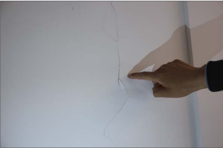
20号楼1单元504室的张女士家，墙壁裂缝已非常严重。
