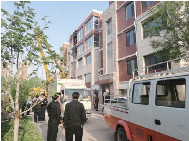
执法人员对违建进行了强制拆除。 图片由通讯员提供
