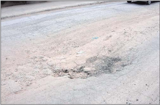
河口区公园街,整条街道一眼望去路面坑洼不平,给往来车辆行车造成了不便。 本报记者 解岩 摄影报道
