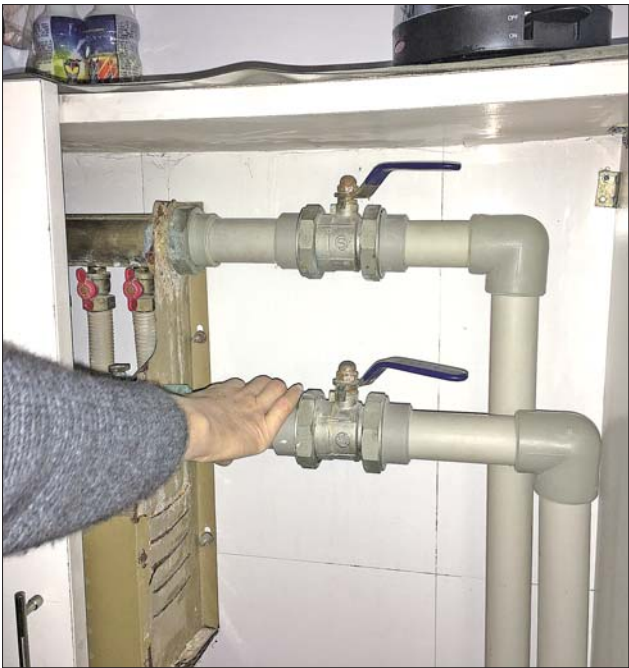
业主家中进水管线与出水管线都不热。
