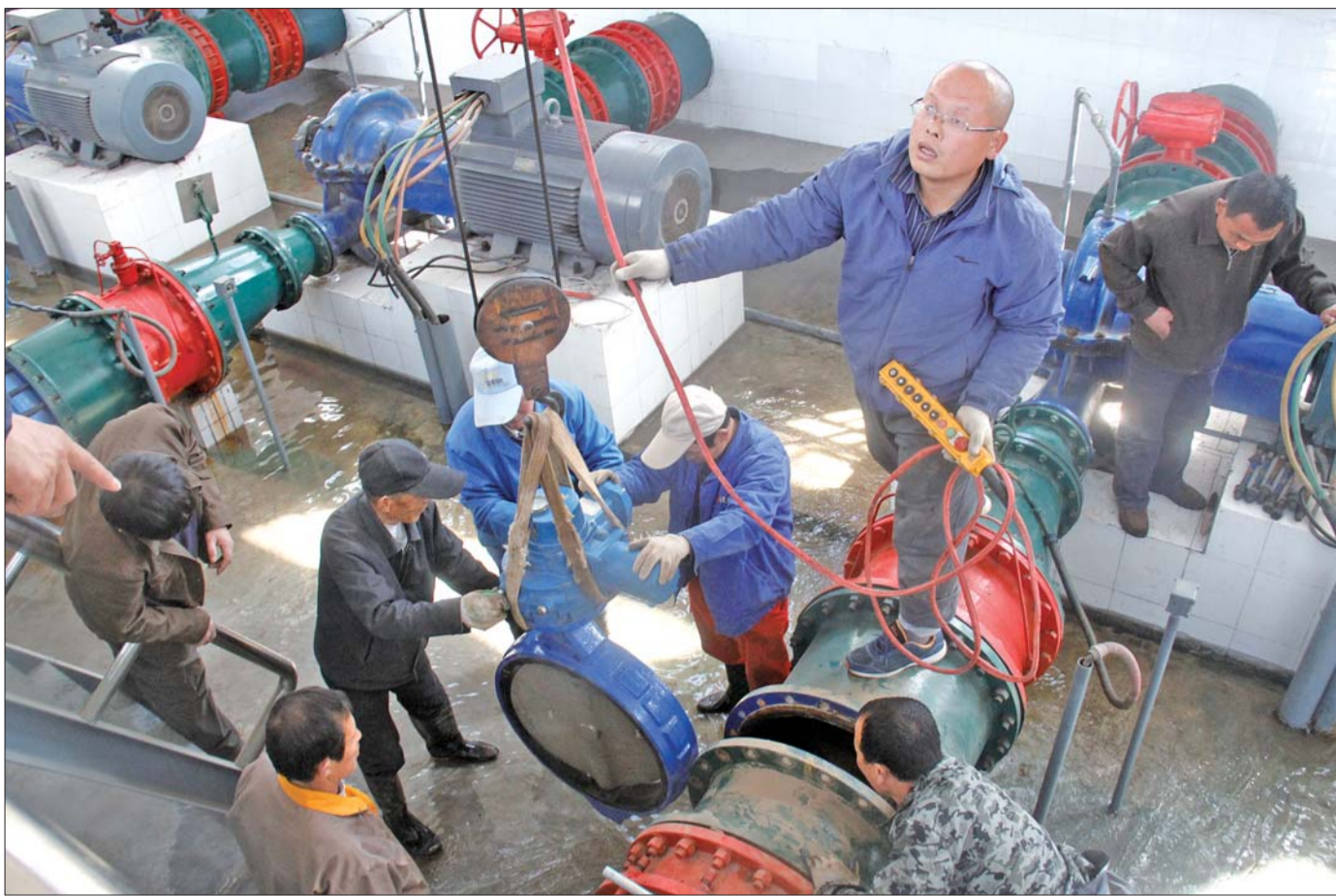
南郊水厂的二级泵房内工作人员正在检修。本报记者 郑美芹 摄
