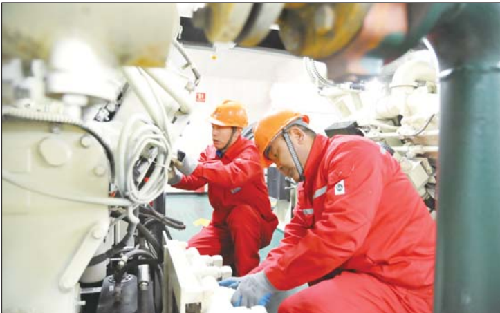
职工正在维护保养平台舱室设备。
