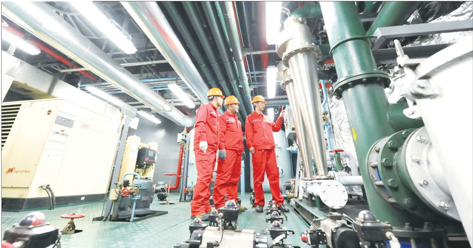
“胜利作业六”平台采用了先进的污水处理管汇体系。
