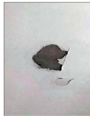
郭先生家里天花板墙皮掉落。本报记者 郭小雨 摄
